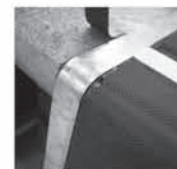
炭素繊維が片面のみ貼られた様子。 Carbon fiber applied to one side first
